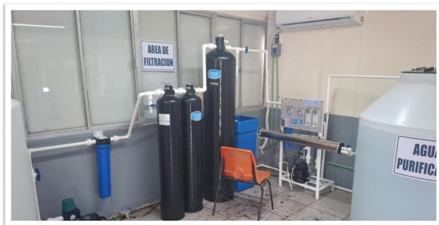
Figura 53. Mantenimiento a planta purificadora del TecNM Altamira
